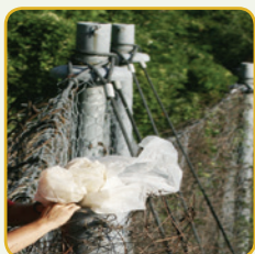
Poteaux des filets anti-dispersion des déchets
