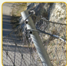
Poteaux des filets anti-éboulement 2
